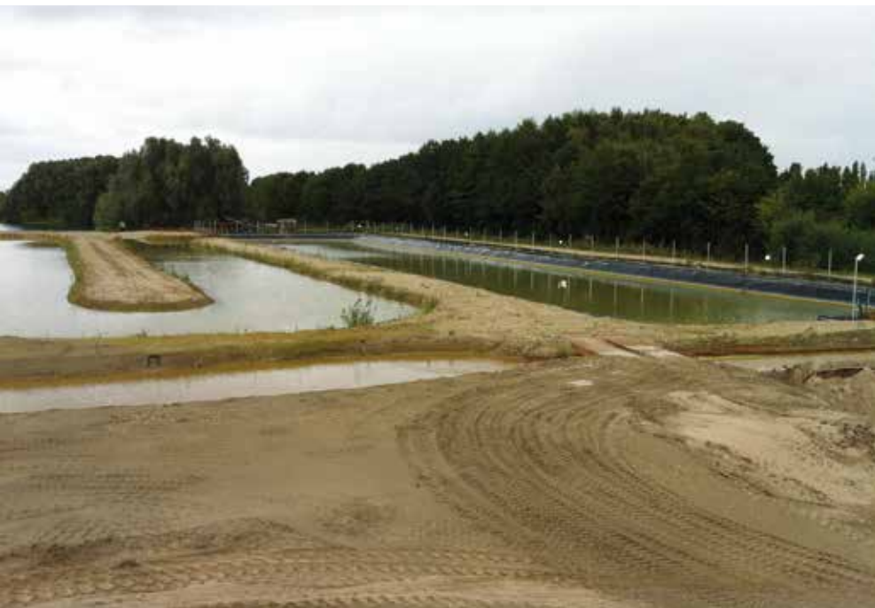
Absetzgräben mit Vorratsbecken für Klarwasser.
