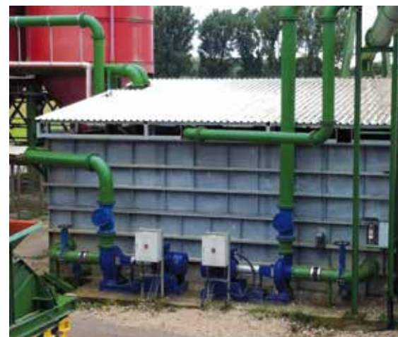
Zwischenspeicher mit Pumpen für die Sandaufbereitung und Siebmaschinen.
