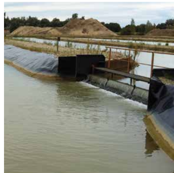
Heute ist nur noch eine Frischwassermenge von 1400 m 3 /h für die Gesamtanlage notwendig, der restliche Prozesswasserbedarf wird durch Recyclingwasser gedeckt.
