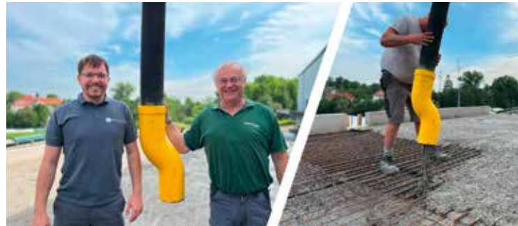
BETONAGE: Schutz vor Entmischung und Verschmutzung bietet die arbeits sicherheitskonforme (TÜV/AUVA) Betonbremse mit Schlauch.
