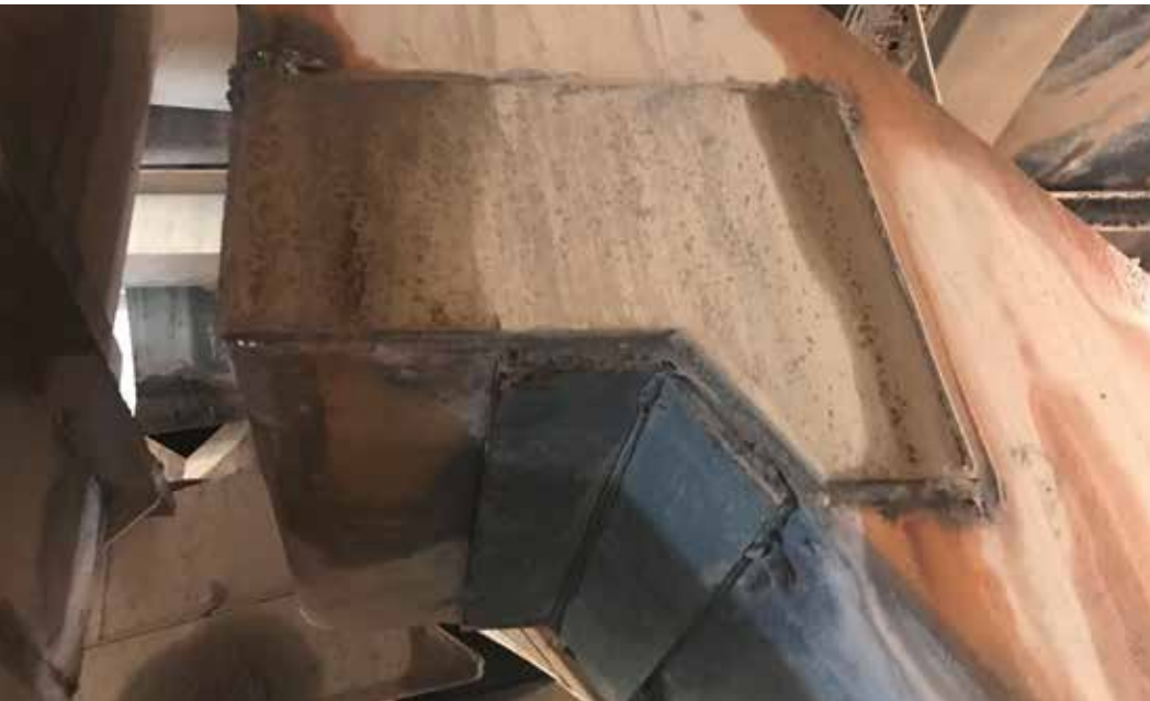
FLICKENTEPPICH: Anlagenteile verschleiben und müssen regelmäßig aufwendig geschweißt und gekittet werden. Tecthan sorgt in solchen Fällen – auch wenn sie sehr herausfordernd sind – für dauerhafte Abhilfe. Fotos: Polytec
