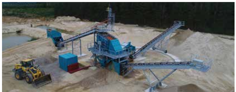
Waschanlage in Modulbauweise
