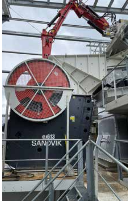
KEINE BLOCKADEN: Der Primärbrecher ist mit einem Rammer-Hydraulikhammer ausgestattet.
