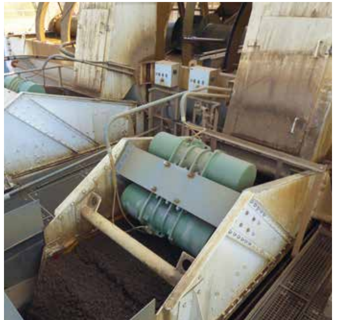
ALLTAG IM KIESWERK: Horizontale Linearsiebe zur Entwässerung arbeiten meist mit zwei Unwuchtmotoren oberhalb des Siebdecks. Foto: bwi
