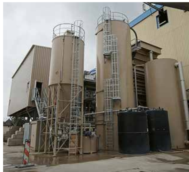
SCHLAMMBÄNDIGUNG: Die Taktzeiten der Kammerfilterpresse sind eine feste Größe. Der ausgefallte Schlamm des Lamellenklärs „wartet“ in Silos auf den Entwässerungsvorgang.
