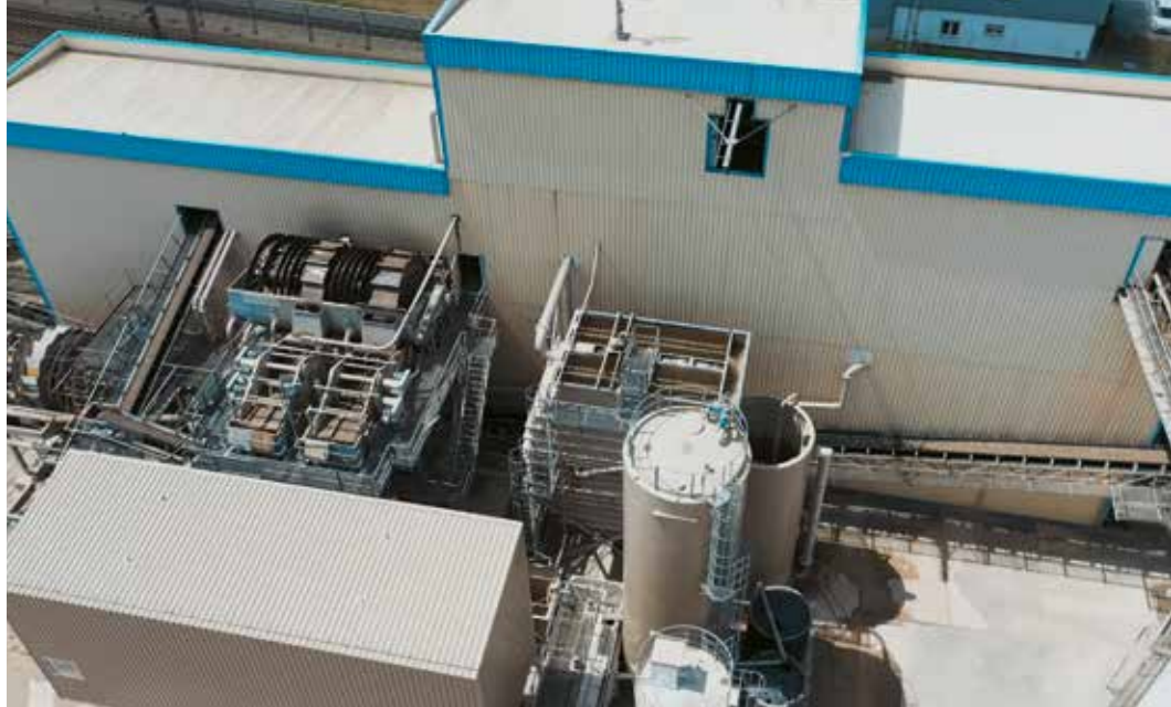
WERK AN WERK: Die vielstufige Aufbereitung für den Tunnelausbruch wurde an der Außenseite des bestehenden Werkes errichtet und teilweise eingehaust.
