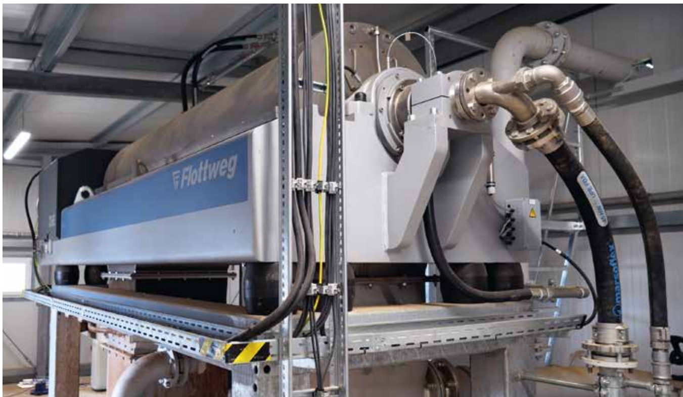
ANFALLENDEN WASCHWASSER wird im geschlossenen Kreislauf mit dem Flottweg-Z6E-Dekanter aufbereitet. Foto: Flottweg
