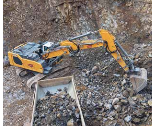
SOWOHL IM STEINBRUCH als auch auf Erdbaustellen wird der vielseitige Raupenbagger R938 eingesetzt.
