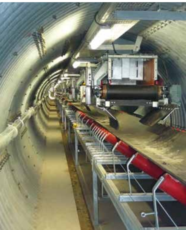
VON A NACH B: Förderbandunterführungen wie diese kreuzen bspw. Verkehrsströme, wenn die Notwendigkeit besteht.
