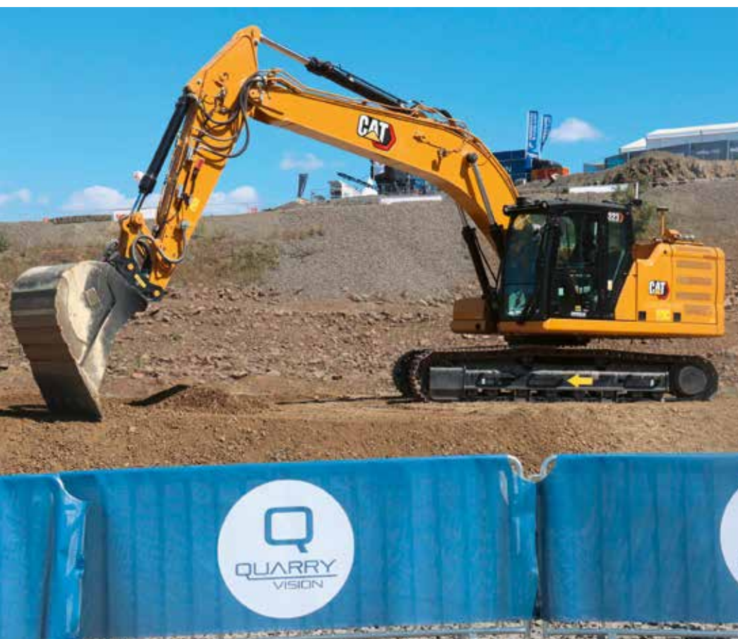
FERNGESTEUERT: Der Fahrer arbeitet von einer externen Bedienstation aus, während der Cat-Kettenbagger 323 rund 30 m entfernt steht. Fotos: Zeppelin
