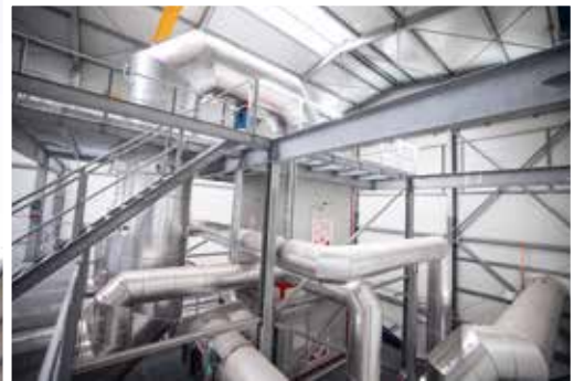
RIESIGE RAUCHGASROHRE befördern das Rauchgas von der Brennkammer zu den speziellen Rauchgas-Luft-Wärmetauschern.
