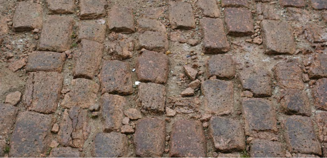
Abb. 11: Pflastersteine aus dem halleschen Gebiet, verlegt in Bernburg (Sachsen-Anhalt), zeigen starke Schäden bis hin zum Zerfall einzelner Steine (Foto: H. Siedel).
