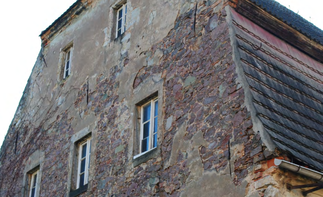
Abb. 5: Wohngebäude in Oschatz mit Bruchsteinmauerwerk aus Rhyolith unter dem schadhafte Verputz (Foto: H. Siedel).
